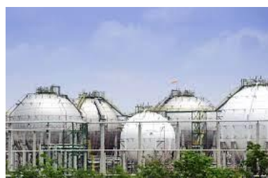
Stockage de gaz
